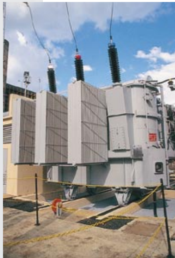
Cia. de Geração de Energia Tietê - Ujina Ibitinga Arreglo 46/56 MVA - Clase 145 kV
