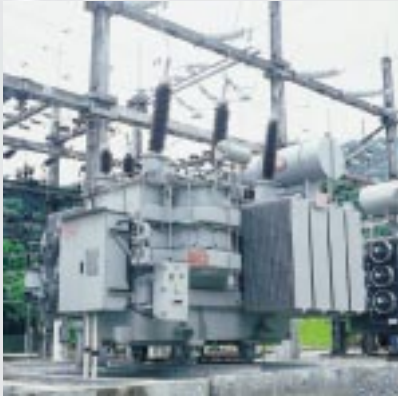
CELESC - Centrais Elétricas de Santa Catarina - 20/26 MVA - Clase 145 kV - Con conmutación bajo carga
