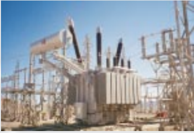
Cia. Minera Zaldivar 40/50/60 MVA - Clase 242 kV
